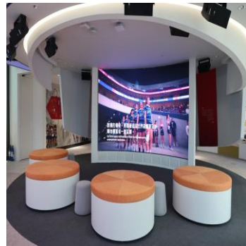
启德体育园项目展馆 视听系统
