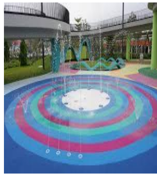
启德体育园水景系统
