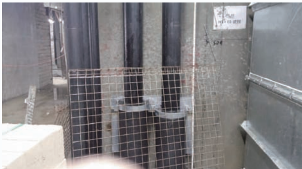
喉管井道以鐵絲網隔開以防止從高處墜落
